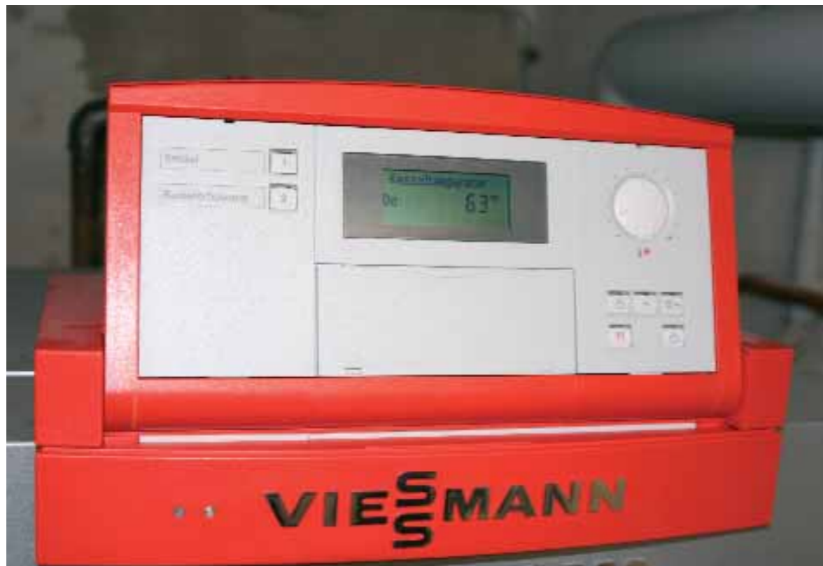
Regler eines Heizkessels in der Schwartzkopff-Siedlung
